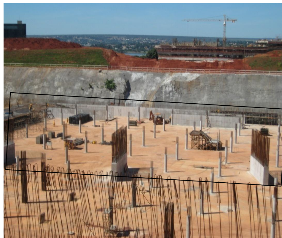
Foto 12 – Concreto Pilares 3º subsolo, trecho V(exceto os compreendidos entre os eixos 11-13 e H-P.), ref. Item 03.02.700 do Memorial descritivo
