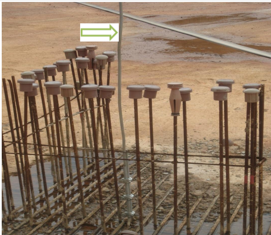
Foto 14 – Aterramento e proteção contra descargas atmosféricas, ref. Item 06.01.500 do Memorial descritivo
