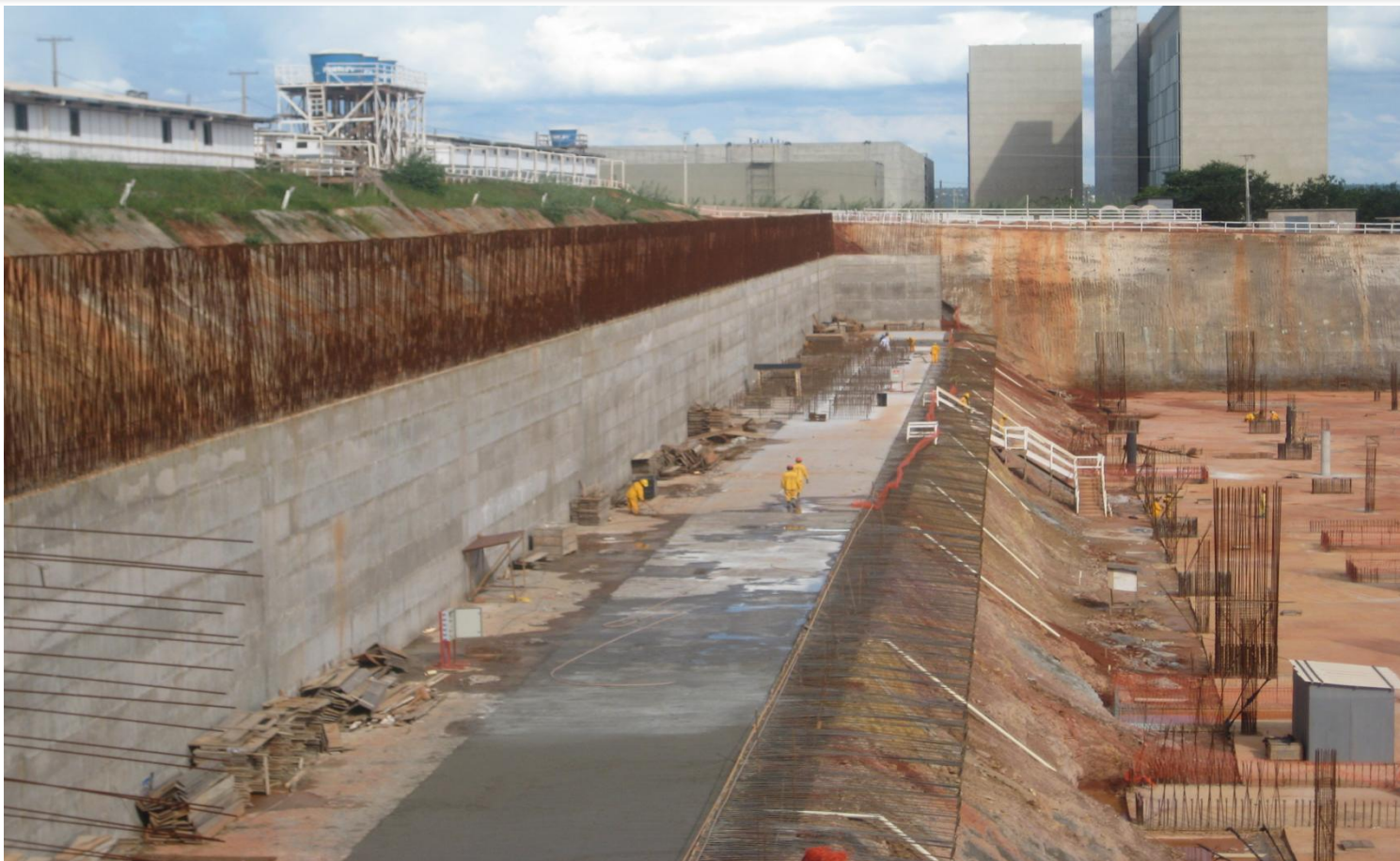
Foto 13 – piso subsolo nível 1049,55 faixa entre eixos 1-2 com largura de 5,67m- trechos I,II,III, ref. Item 03.02.900 do Memorial descritivo
